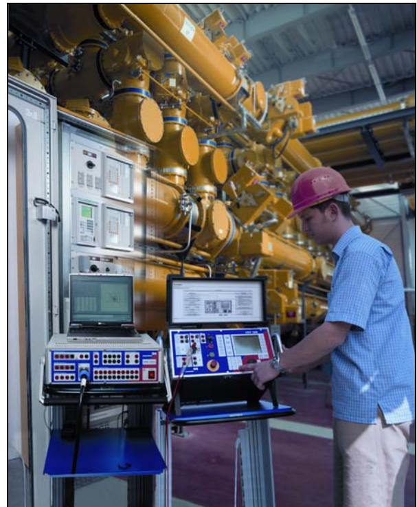
Bild 14: Sekundärprüfgerät CMC 256 und Primärprüfeinrichtung CPC 100, OMICRON, im Einsatz
