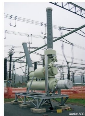
Bild 3 Neues 380-kV-Hybrid-Schaltfeld Quelle: ABB
