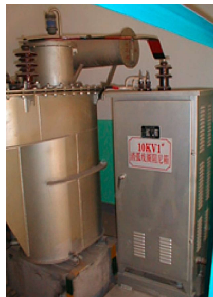
Bild 8: Erdschlussspule bei HPSC, China
