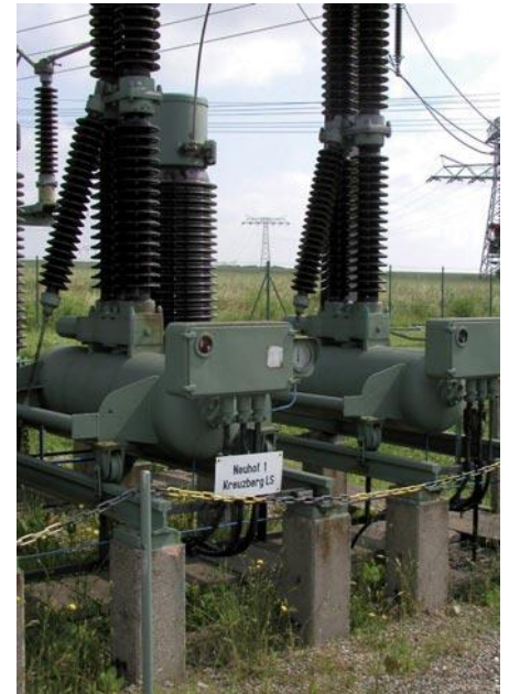
Bild 8: UW Wolkranshausen, 110-kV-Schaltfeld Neuhof
