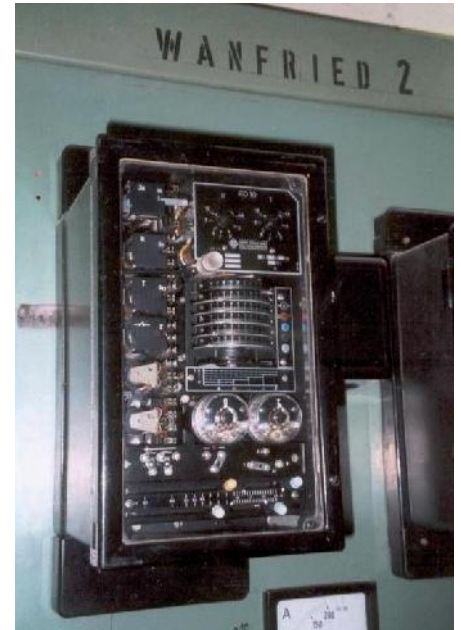
Bild 4: Distanzschutz RD10, EAW, UW Katharinenberg, 30-kV-Leitung Wanfried
