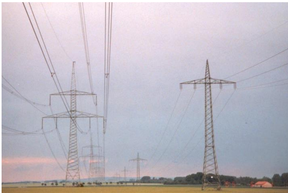
Bild 12: Leitungen der Wiedervereinigung, Nähe Gotha, 380 kV, 50 Hz u. 110 kV, 16 2/3 Hz 2 .
