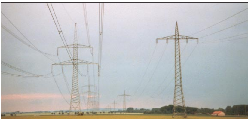
Bild 6. Leitungen der Wiedervereinigung, Nähe Gotha, 380 kV, 50 Hz und 110 kV, 16,7 Hz
