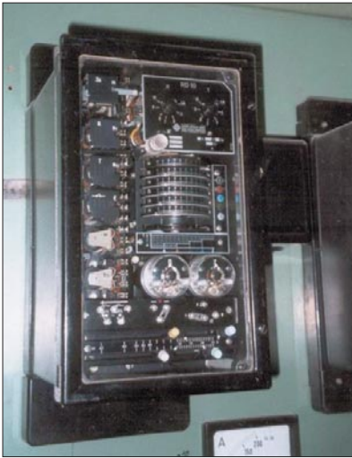
Bild 2. Schutzgerät im UW Katharinenberg, 30-kV-Leitung Wanfried
