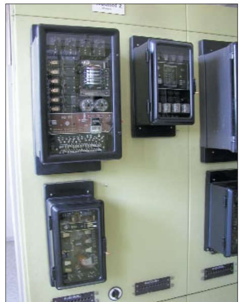
Bild 4. Schutztafel im UW Wolframshausen, 110-kV-Leitung Neuho
