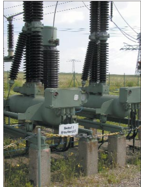
Bild 3. UW Wolframshausen, 110-kV-Leitung Neuho
