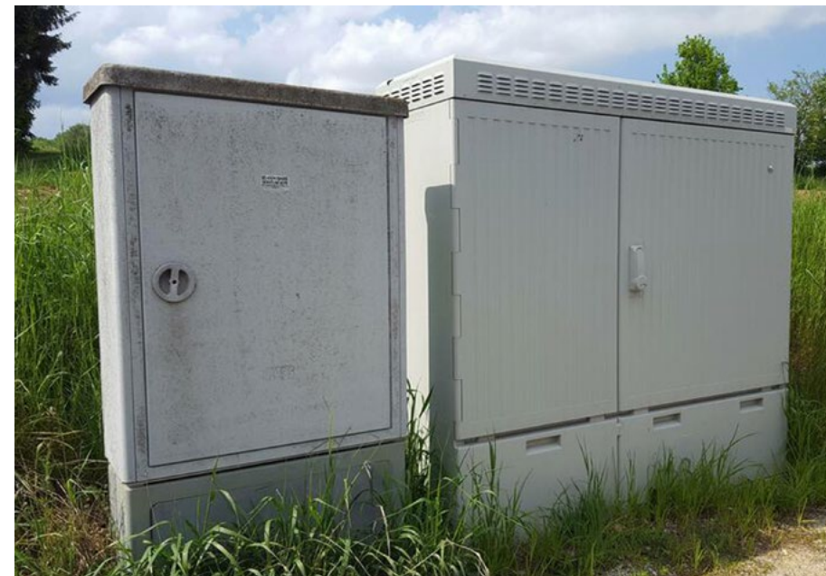
Kabelverzweiger der Telekom
