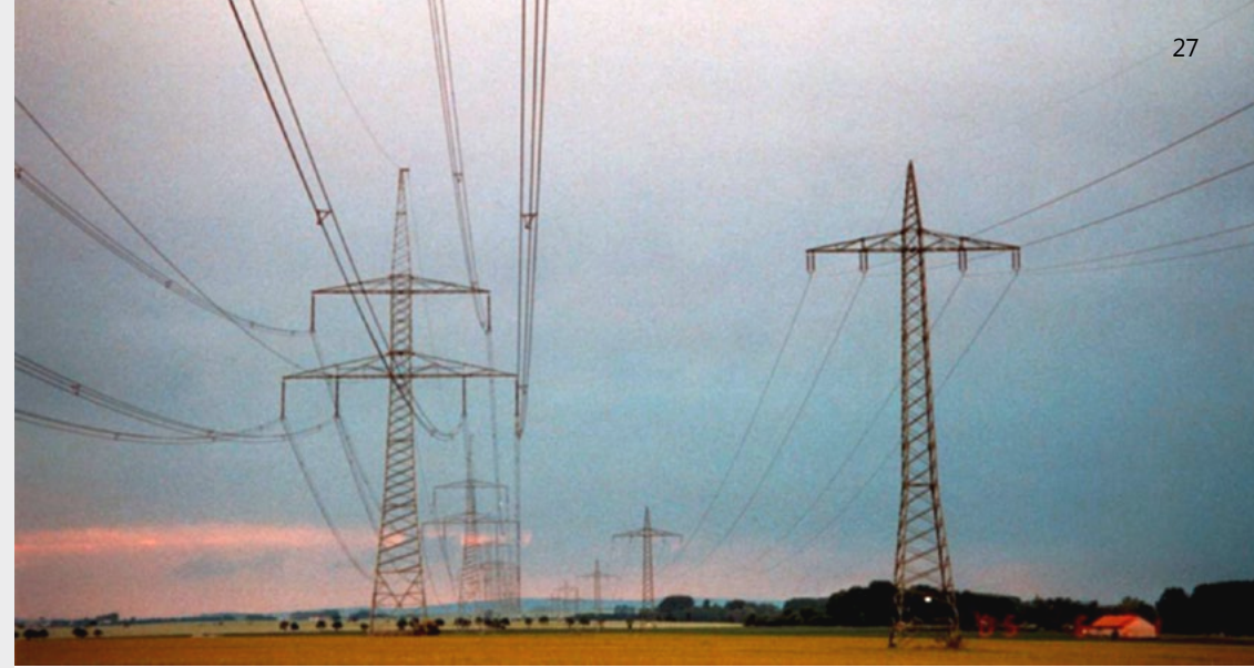
Bild 12: Leitungen der Wiedervereinigung, Nähe Gotha, 380 kV, 50 Hz und 110 kV, 16 2/3 Hz
