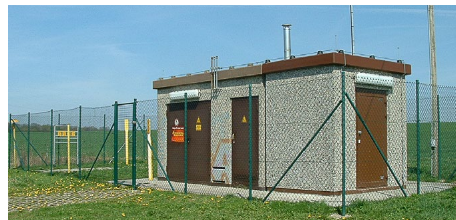
Bild 4: Gasregelanlage (Quelle: Archiv TEAG)
