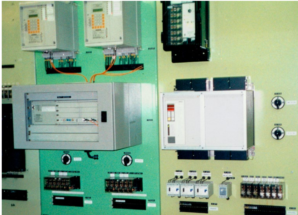
Bild 14: Schutz UW Remptendorf, Abg. Redwitz 253/254, Hauptschutz Distanzrelais PD551 mit AWE-Zusatz RM1-80, AEG und Reserveschutz Leitungsdiff. 7SD512 mit Signalübertragungsgerät SWT2000D, Siemens
