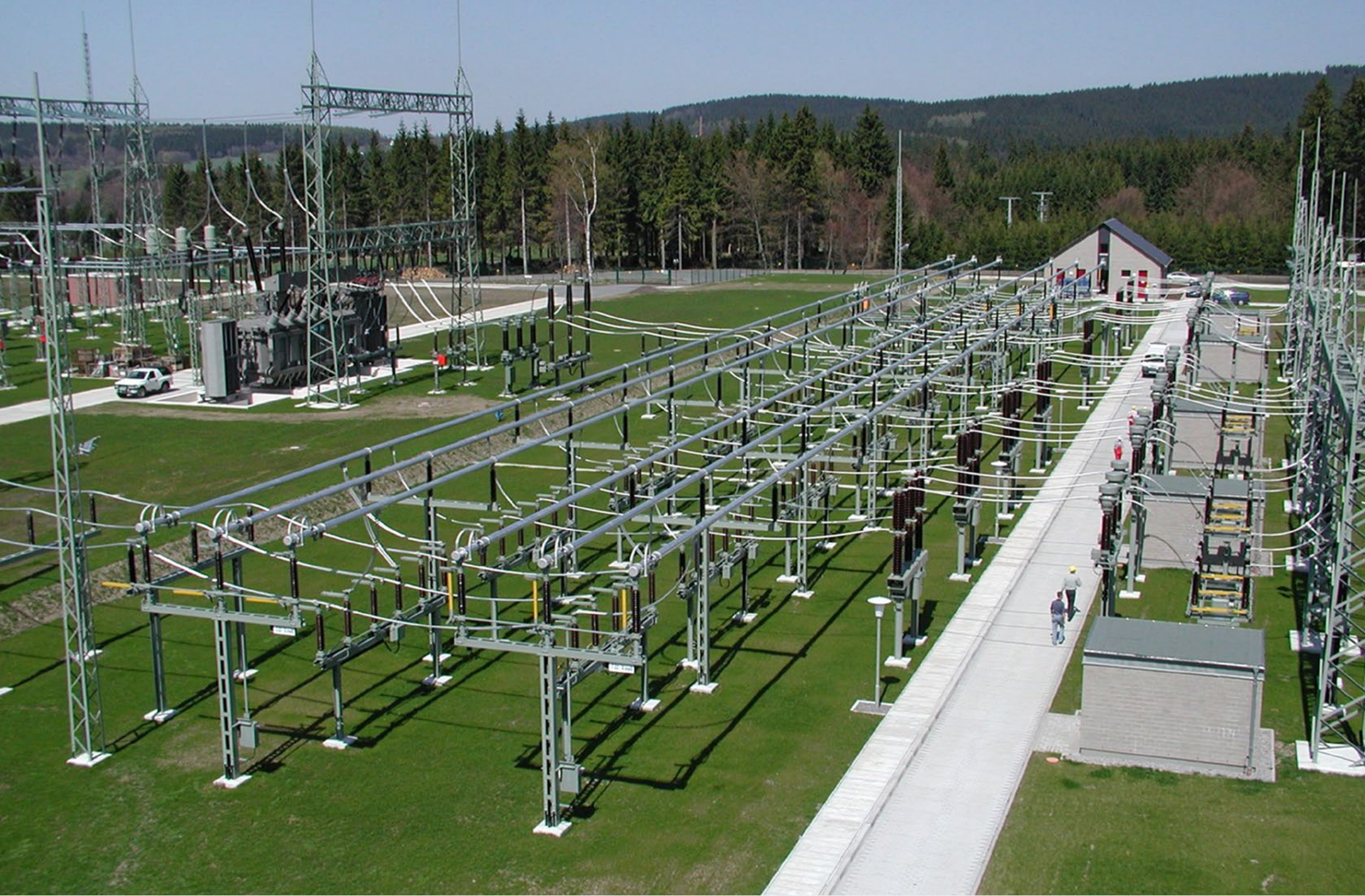
380/110-kV-Umspannwerk Altenfeld, 50Hertz/TEAG, u. a. Einspeisepunkt vom PSW Goldisthal
