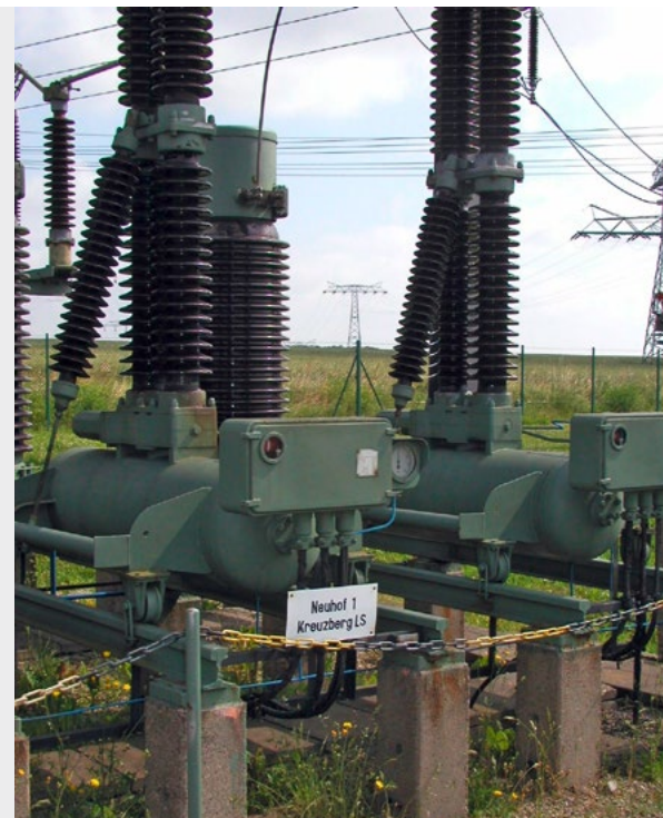
Bild 8: UW Wolkramshausen, 110-kV-Schaltfeld Neuhof 1
