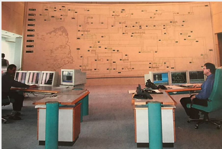
Bild 9: Zentrale Steuerungsstelle der VEAG (Berlin, Beilsteiner Str. 115)
