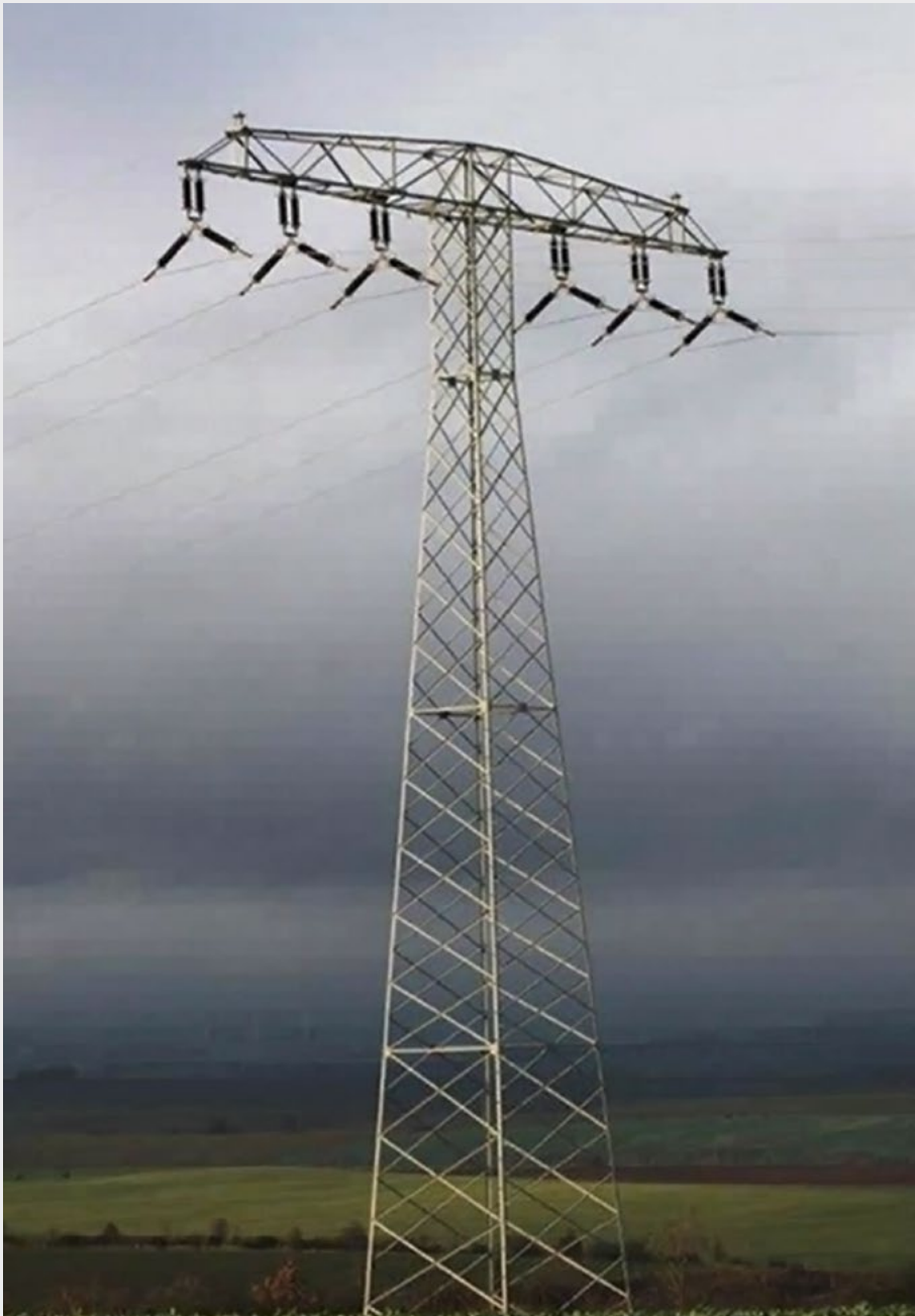
110-kV-Leitung Wolframshausen (Thüringen)–Neuhof (Niedersachsen)
